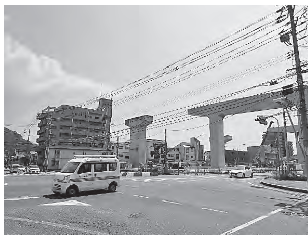
図-2 架空線状況
