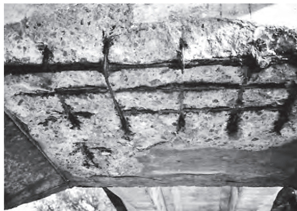
写真 鉄筋コンクリート橋の劣化状況 1)
