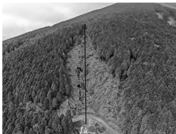
（写真－5）崩壊地③ 被害木処理から施工 黒線はケーブルクレーン法線
