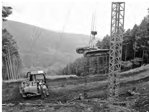
（写真－8）重機分解、運搬状況 （重機を分解し、組立順に施工箇所まで運搬）
