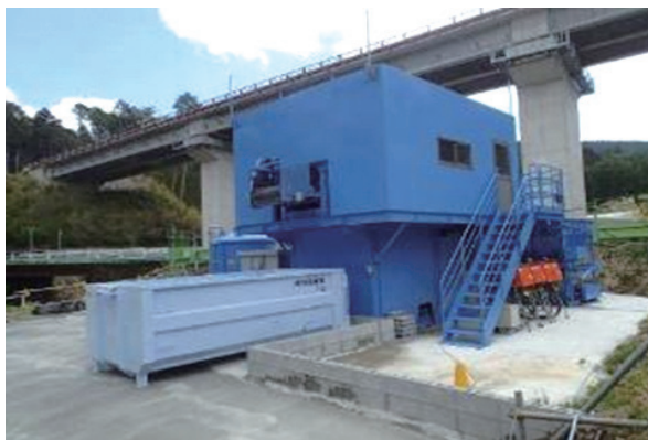
写真-10 濁水処理設備
