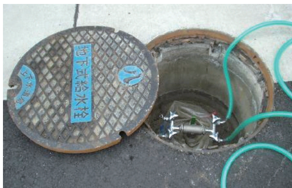
(写真13) 地下式給水栓
