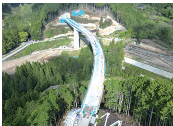
写真-4 国道257号4号橋 (R7.9)
