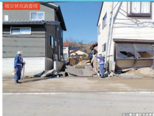
写真-3 道路隆起箇所の調査 (道路班)
