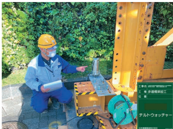
写真-4 傾斜管理システム (ベント設備)
