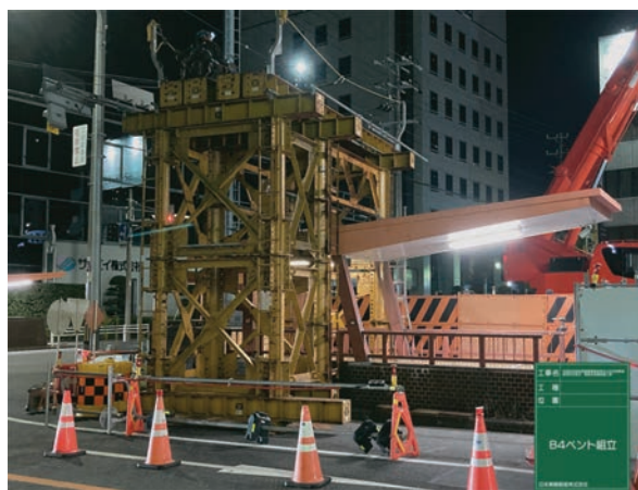
写真－3 門型ベント設備
