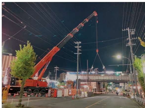
写真－2 通行止め状況
